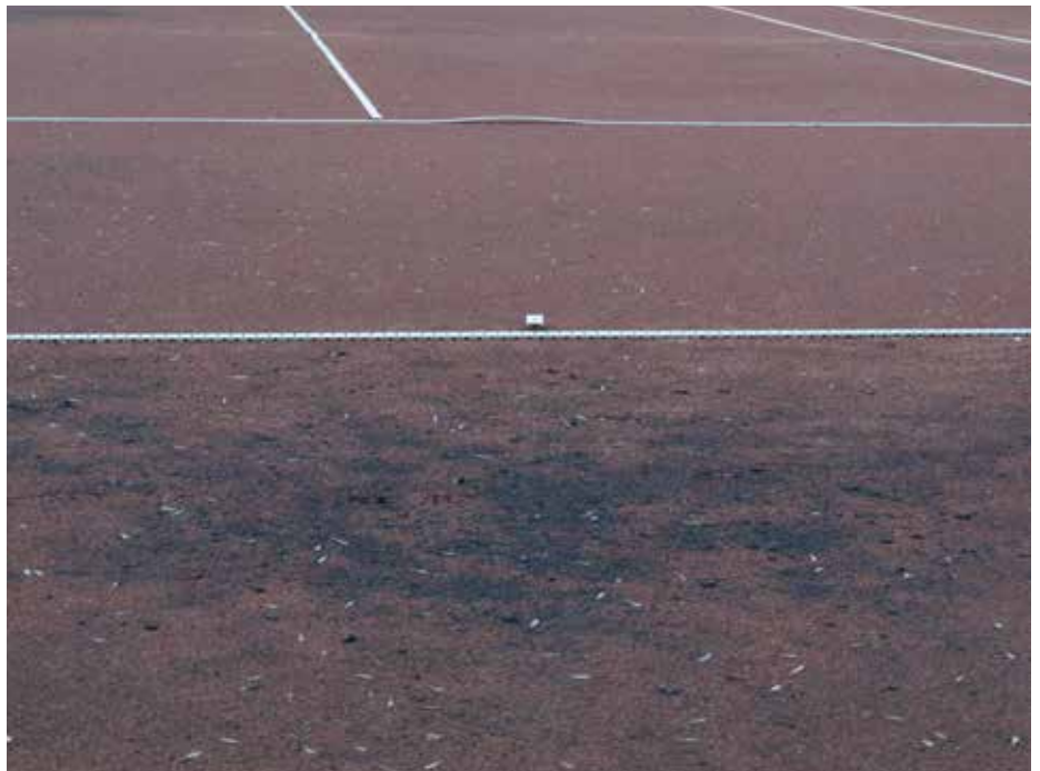
Toto je ďalší deštruktívny efekt cyklického zamrzania a rozmrzania kurtov počas zimy. Podložná škvara je ľadom vytlačená nad vrstvu antuky. Na obrázku zároveň vidno, že strata súdržnosti antuky sa prejavuje aj vyliezaním plastových čiar nad antukový povrch. Tie sú totiž v lete ukotvené trením dlhých fixačných klincov v povrchových vrstvách kurtu.
